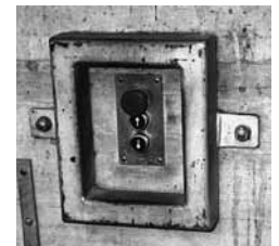
Bild 4: Eingemauerte oder mit einem robusten Rahmen versehene Bedienungsorgane sind gegen das Angefahrenwerden von Fahrzeugen geschützt.
