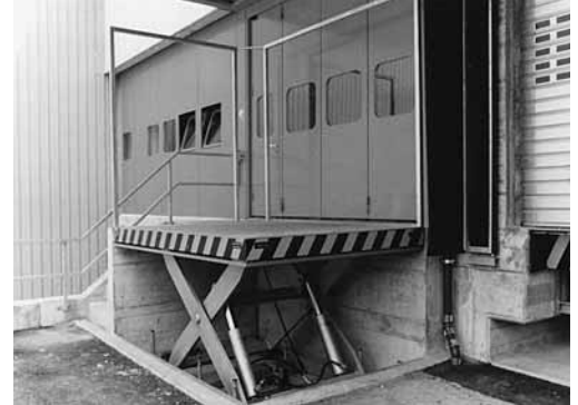
Bild 1: Beim Absenken der Hebebühne bewegt sich auch das Geländer nach unten und bildet eine Abschrankung für die oberen Zugänge.
